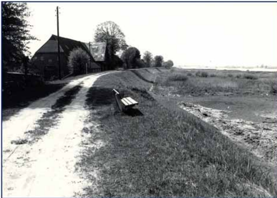
Zu steile Außenböschungen – Merkmal der Deiche alter Bauart (hier: Schwinde, Zustand 1974)
