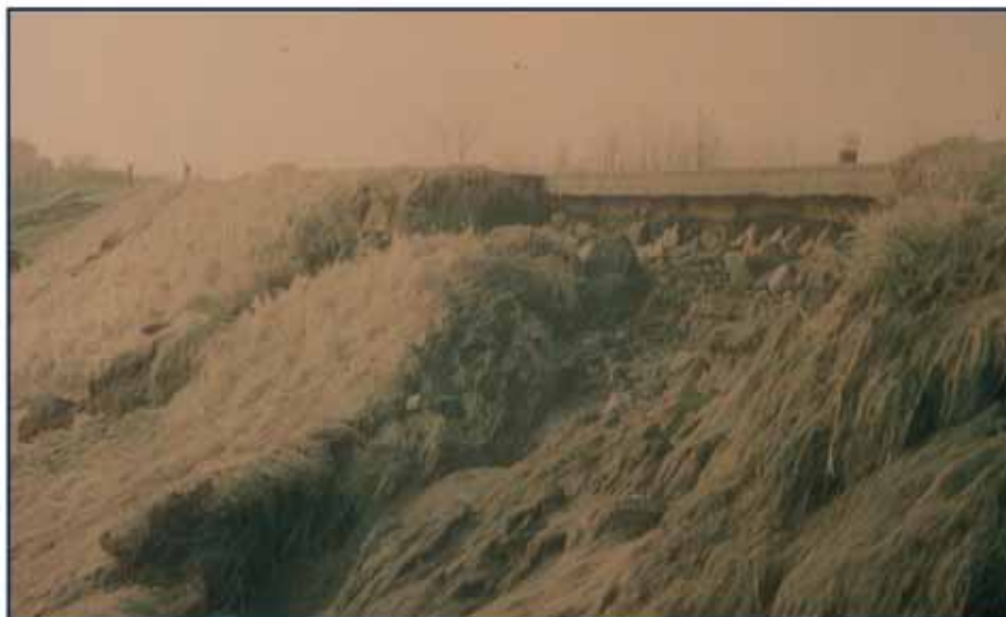
Schaden an der Binnenböschung durch Überströmung in Bullenhausen
