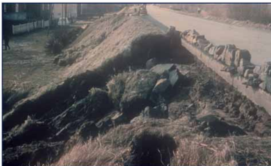
Durch Überflutung entstandene Schäden an der Binnenböschung (Bullenhausen)
