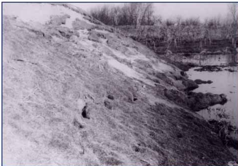
Erosionsschäden an der Deichbinnenböschung durch Überlauf
